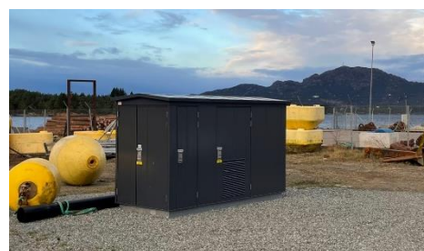
Ny nettstasjon Serklau
